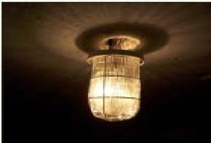
Foto 49: Foco con mecanismo anti desprendimiento de vidrio
